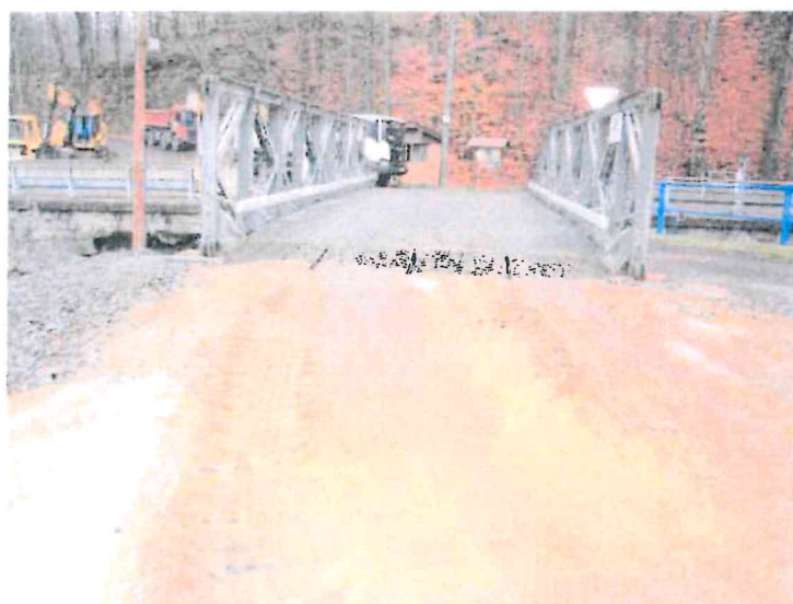
Pohled na MP proti směru staničení k sil. I/60 - absence SDZ DZ viz. text 1. HPM
